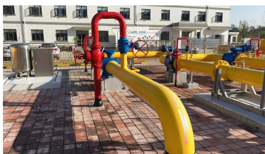
天然气出口管道
